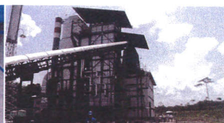
La centrale électrique à Itacoatiara. Un tapis roulant transporte les déchets de bois à la chaudière.
