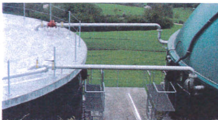
En Suisse, un toit à double membrane couvrant la cuve de méthanisation, ainsi qu'une aire fermée de stockage du digestat, garantissent une étanchéité totale évitant toute émanation de méthane dans l'atmosphère.
